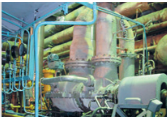
С Фото 2. ПВМ АВР-1000 с генератором электрической мощностью 1000 кВт в производственной котельной
